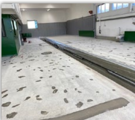
Reprofilieren von Ausbruchstellen und Verschluss von Rissen mit einer Mischung aus Epoxidharz und Quarzsand.
