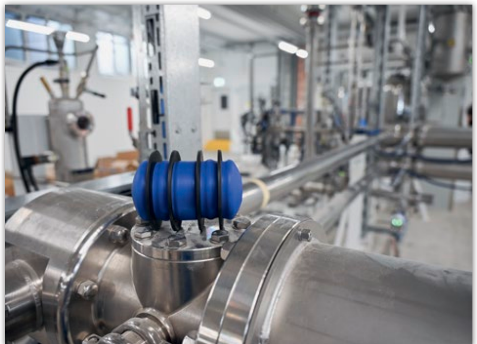
Einer der Molche, die für Sauberkeit und Hygiene in den Leitungen sorgen.
